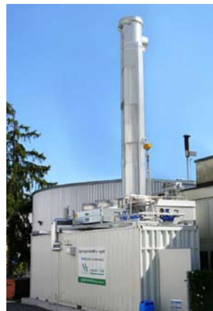
BCM-Sorb Biomethananlage 2008, Klärwerk Meilen; Musteranlage für Gemeinden zur Eigenversorgung mit Erdgas aus Klärschlamm
